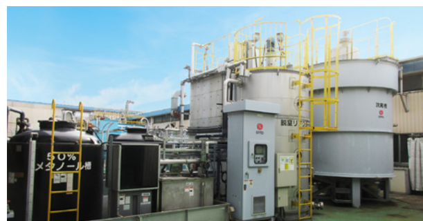
真岡工場 生物脱窒法排水処理施設
